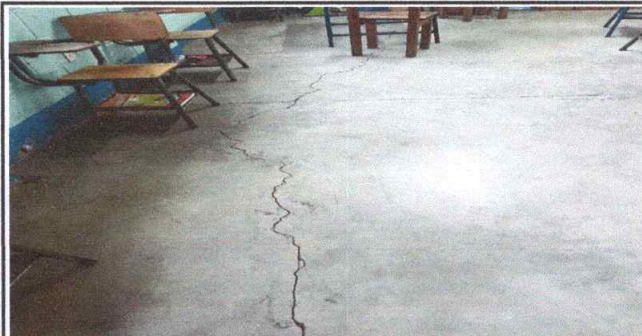
Foto 4: Sustrucción de piso de granito
